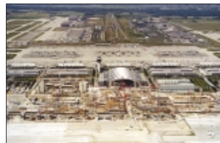
Die Gesamtansicht vom im Bau befindlichen Terminal 2 gibt eine Ahnung vom Umfang des zu realisierenden Netzes (Foto: FMG)
